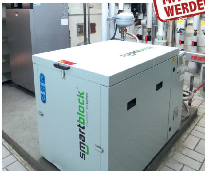
Das neu moderne Blockheizkraftwerk
